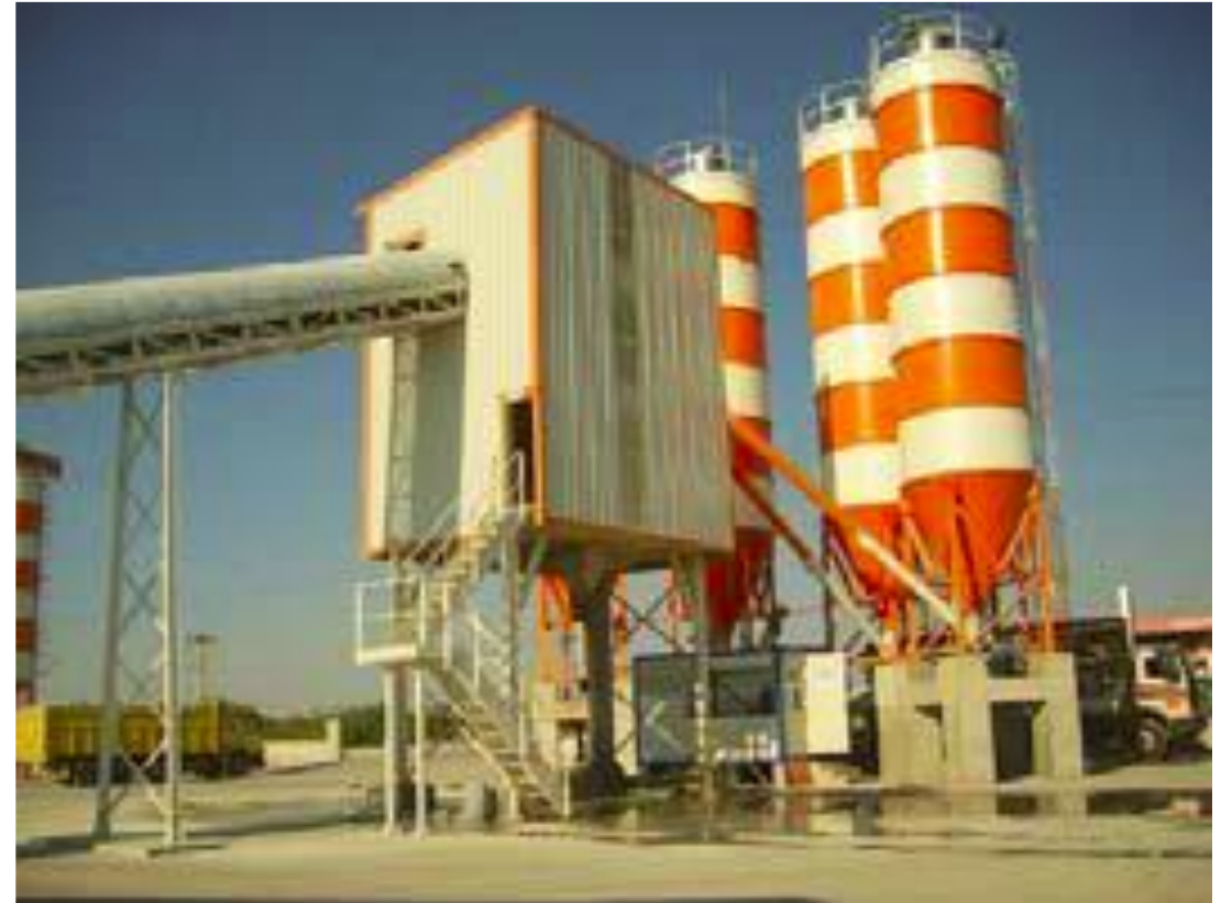
دستگاه بتن ساز
